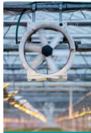
Controle van aansluit-snoeren ventilatoren, vlakbij het schermdoek.
